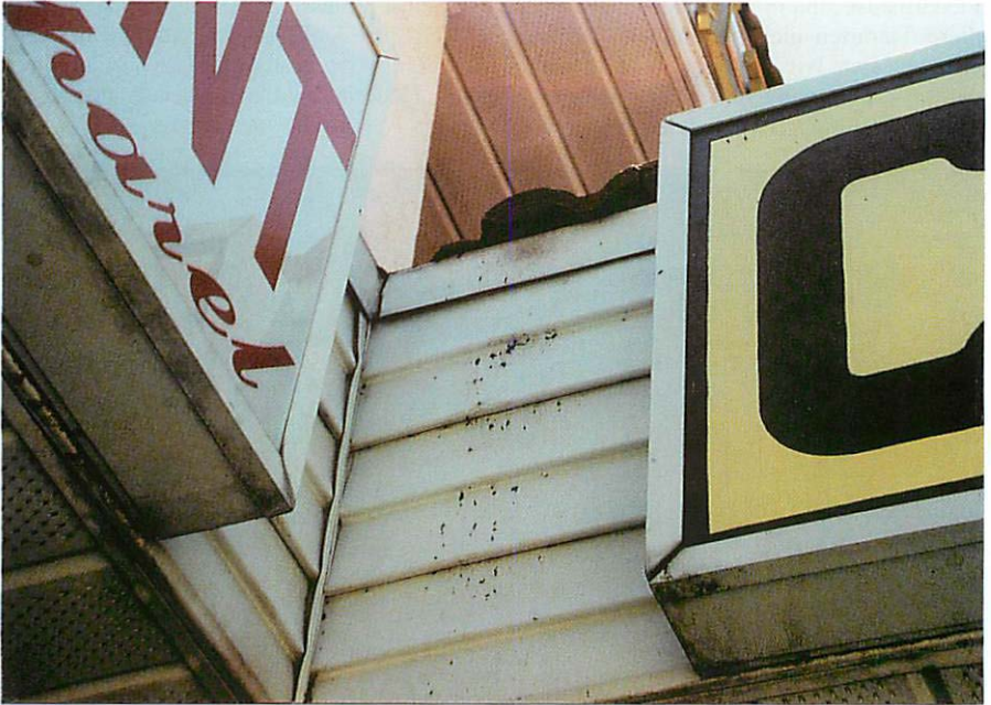
Abb. 11. Das Quartier in einem Einkaufszentrum befand sich unter halbrunden Dachziegeln. Reichlich Kot auf dem Parkplatz verriet das Versteck der Fledermäuse. Aufn.: H. SCHWARTING
