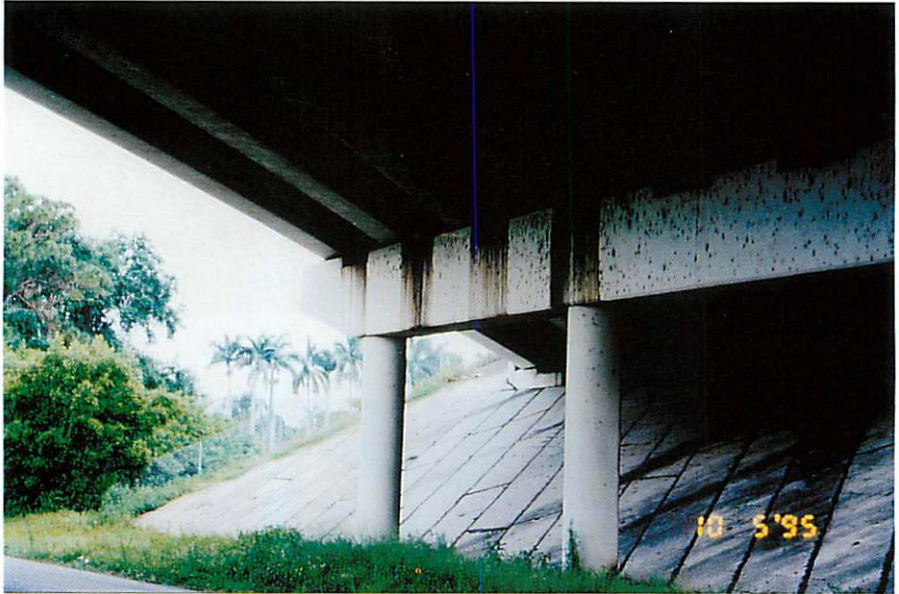
Abb. 6. Der Guano lag massenhaft unter der „La Villa Road“-Brücke. Die Betonteile sind erheblich durch Kot und Urin verschmutzt und weisen auf eine größere Kolonie hin. Aufn.: H. SCHWARTING
