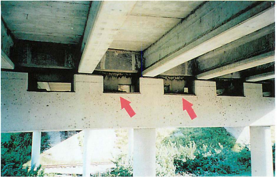
Abb. 3. Zwischen der Fahrbahnunterseite und den Trägern waren die Wände erheblich mit Urin und Kot versehen. Unterhalb dieser Stellen war die Betonkonstruktion durch Exkrememente der Kolonie bedeckt.
