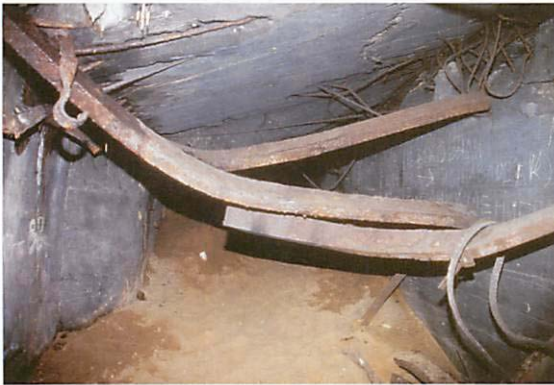
Abb. 5. Stark verbrochener Versorgungsgang unter der Maybach-Anlage I, der an dieser Stelle nur kriechend zu passieren war. An der Wand russische Schriftzeichen. Aufn.: R. BAIER/Rangsdorf
