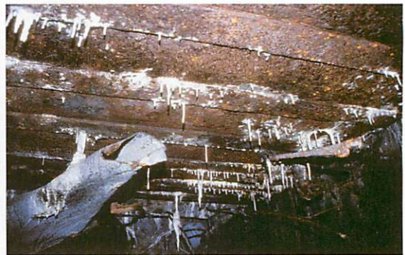
Abb. 6. Stark verrostete, teils verbogene und dadurch beste Fledermausverstecke bietende Eisenbewehrungen mit Stalaktitenbildungen an der Decke einer tiefergelegenen Sektion eines der Häuser in der Maybach-Bunkeranlage I. Aufn.: R. BAIER/Rangsdorf
