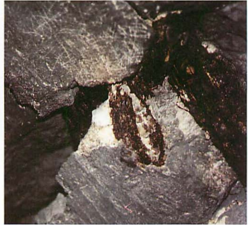
Abb. 14. Mopsfledermaus in durch Sprengung zerklüfteter Betondecke mit verrosteten Eisenbewehrungen in Maybach-Anlage I. Aufn.: DIRK STEINHAUSER, 7.III.1996
