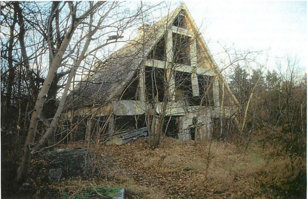
Abb. 1. Eines der gesprengten, doch äußerlich noch einigermaßen erhaltenen Häuser der Maybach-Bunkeranlage I. Aufn.: R. BAIER/Rangsdorf
