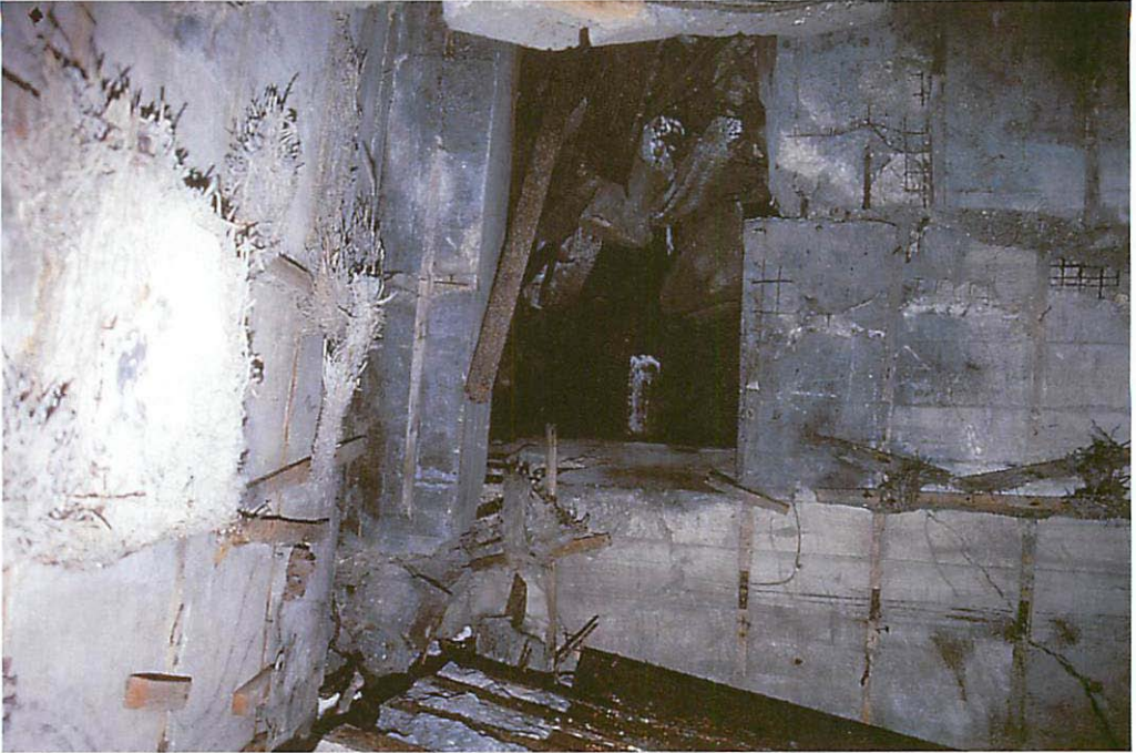
Abb. 4. Ideale Fledermausverstecke hinter Resten von Sauerkohlblatten, mit denen als auf Holzklatten genageltem Dämmstoff einstmals alle unterirdischen Betonkammern ausgestattet gewesen sein dürften, in der tiefsten Sektion eines der Häuser der Maybach-Anlage I. Aufn.: R. BAIER/Rangsdorf
