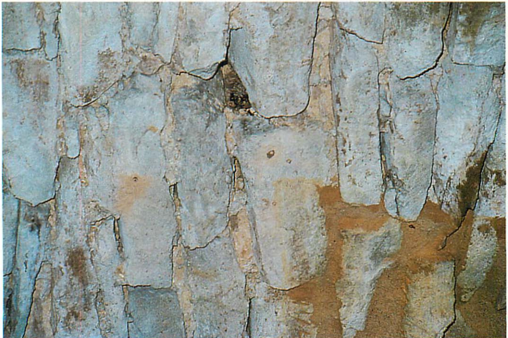
Abb.7. Detailaufnahme von einem neu verfugten und einem nicht verfugten Bereich. Im Spalt in der Bildmitte oben haben sich bereits wieder zwei Fledermäuse eingefunden. Aufn.: H. MAUS
