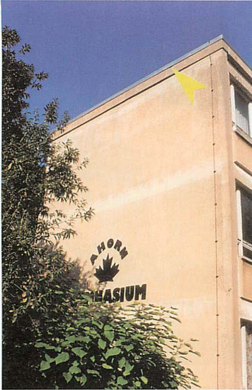
Abb. 7. Danziger Str. Ahorn gymnasium. Die Markierung weist auf den Einflug zu einer Wochenstube der Zwergfledermaus ( Pipistrellus pipistrellus ). Die Stelle mit dem herausgebrochenen Beton ist deutlich zu erkennen. Aufn.: H. POMMERANZ
