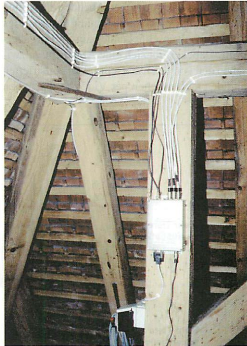
Abb. 4. Datenverarbeitungseinheit an einem Dachbalken montiert. Hier laufen alle Informationen von den Lichtschranken und den Klimasensoren (Temperatur, Helligkeit) zusammen und werden von einem Mikroprozessor verarbeitet. Aufn.: M. KLINGER
