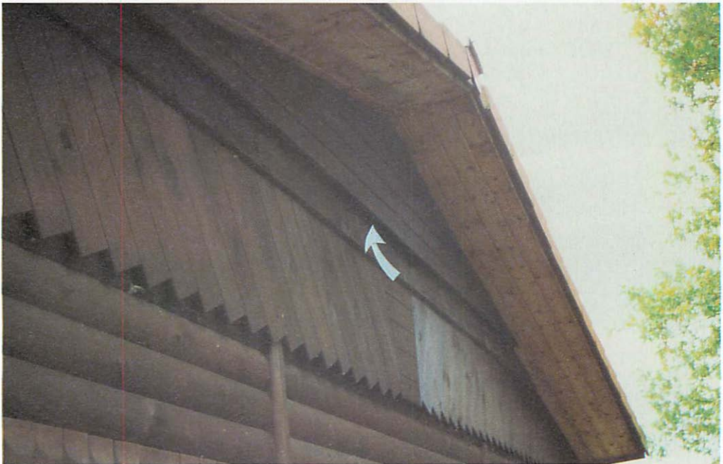
Abb. 3. Spaltenquartier hinter der Giebelverkleidung an der Ostseite der Jagdhütte (Pfeil markiert Einflug). Aufn.: G. HÜBNER
