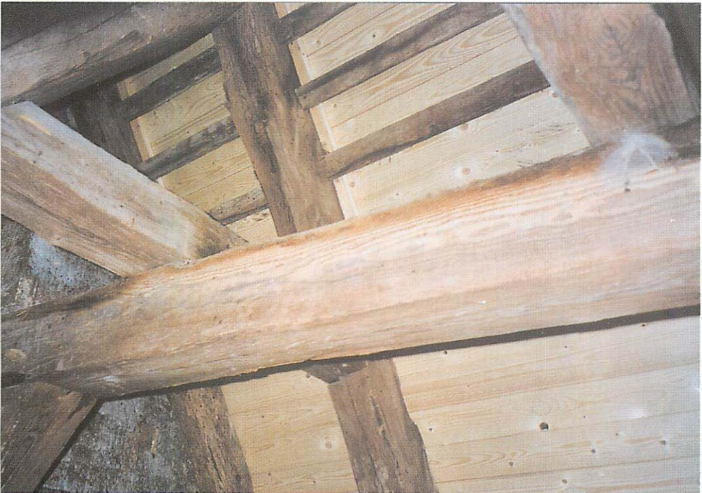
Abb. 3. Neue Dachschalung mit alten Dachlatten. Deutlich sind auf letzteren die Benutzungsspuren, ebensoam Balkenwerk, zu erkennen.
