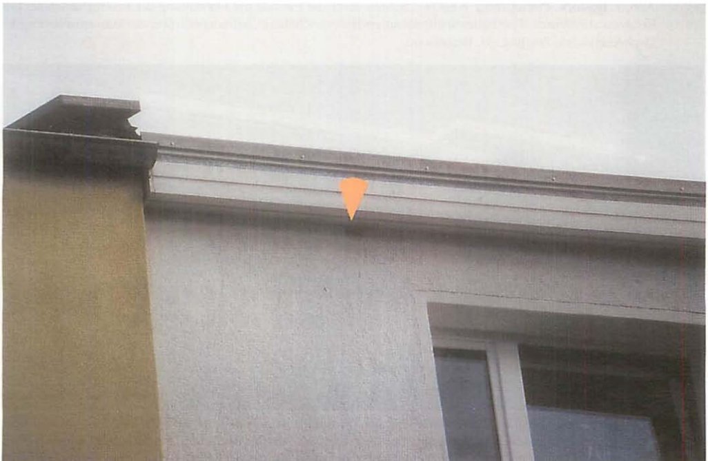
Abb. 6. Rostock, Patriotischer Weg 71 – Nahaufnahme eines Einflugbereiches im oberen Gebäudebereich (Pfeil). Alle Einflüge sind durch die Gebäudewand geführt. Aufn.: U. HERMANNs
