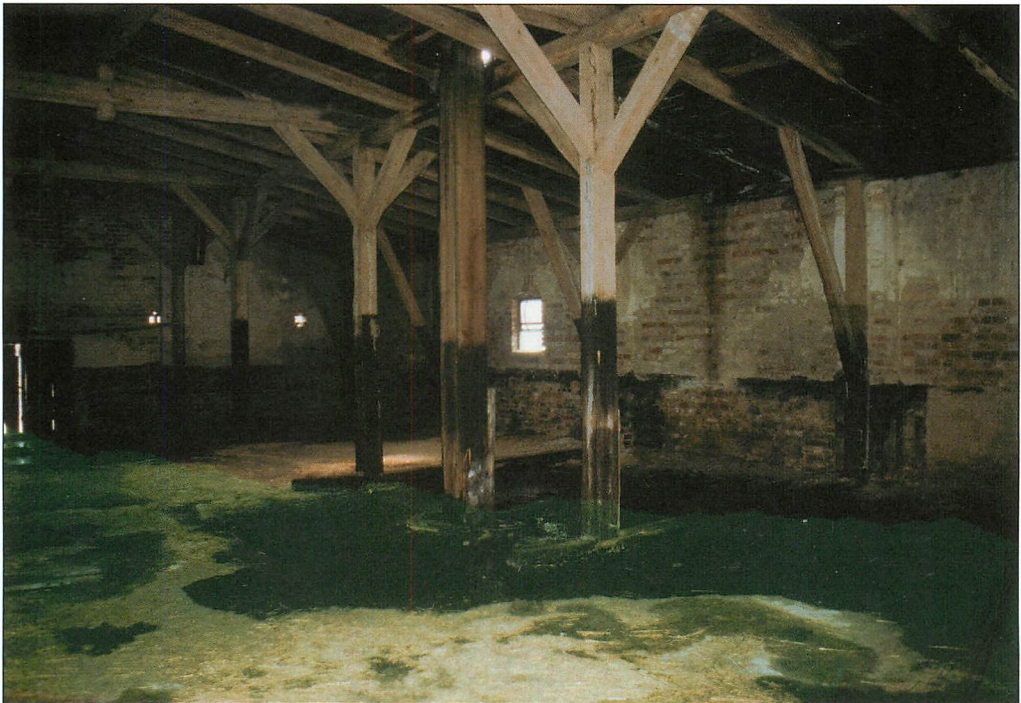
Abb. 7. Zustand des ursprünglich zur Lagerung von Rohfutter dienenden Dachbodens über den Stallräumen vor der Sanierung (2000/2001). Durch die baufällige Dachhaut regnete es durch, und es bestand an einigen Stellen akute Einsturzgefahr. Aufn.: U. GRÜTZMACHER
